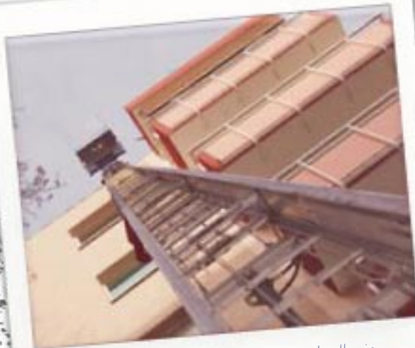
... und der Lastenaufzug bringt sie so schnell wie möglich auf das Dach.
