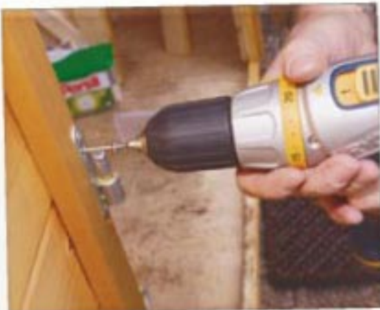
Jetzt muss nur noch alles wieder angeschraubt werden, was vorher abgeschraubt wurde. Den Türrahmen wieder einsetzen, ...
